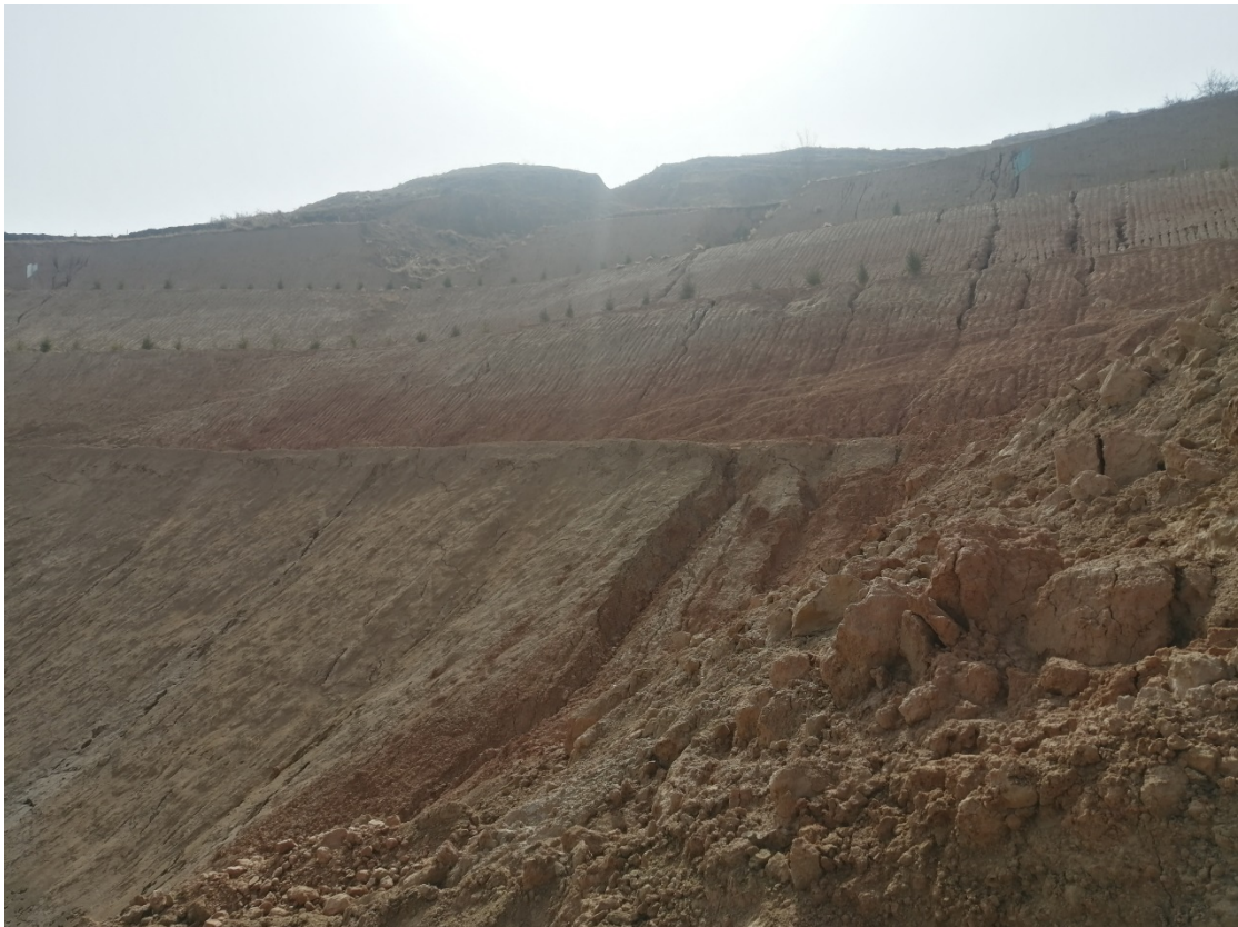
照片 2-5 家兴公司黄铎堡镇南城村五矿边坡恢复治理情况（镜向南东）
